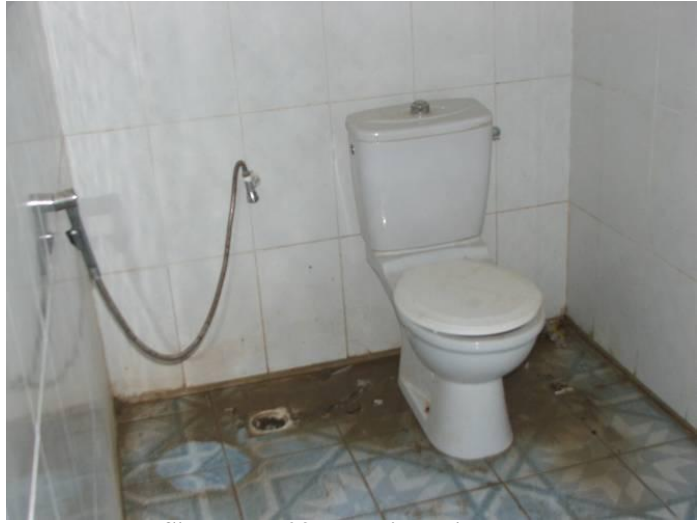
Site Photo 23. Leaking toilet
