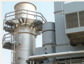
محطة كهرباء كداس
