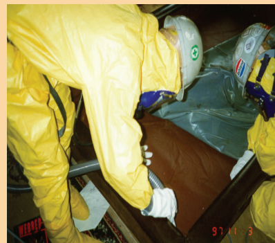
Limpieza del vertido de mercurio en un hogar siguiendo las pautas de la EPA.
